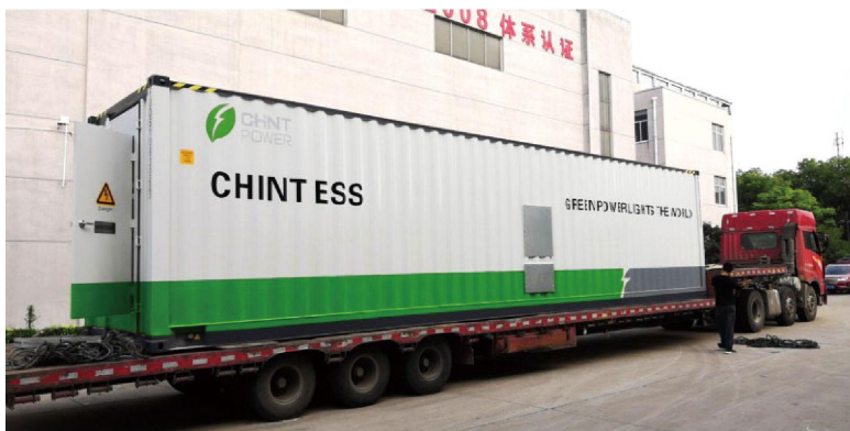
温州园区1MW储能系统项目
