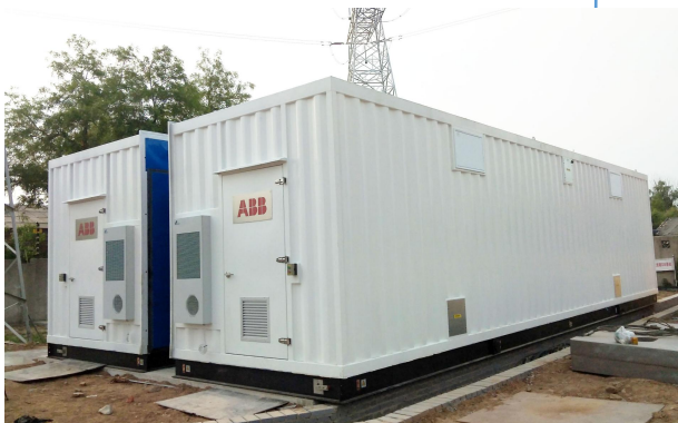
2021年5月 abb北京张仪 220KV变电站改造预制舱项目
