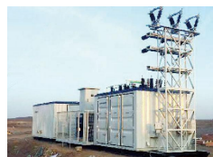
将军戈壁二号露天煤矿一期移动变电站
