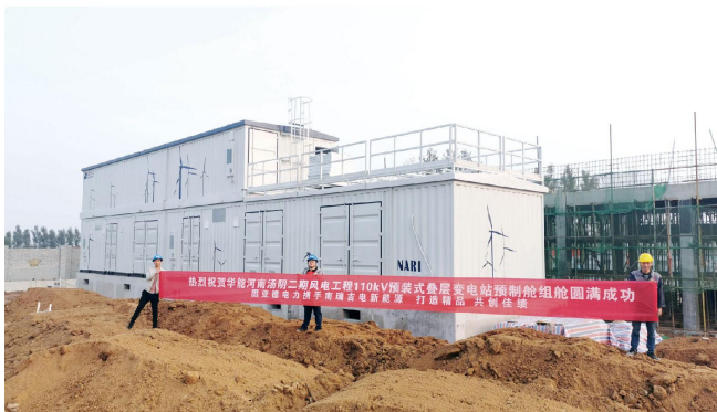
2019年10月 华能汤阴二期 风电场工程110kV预装式变电站
