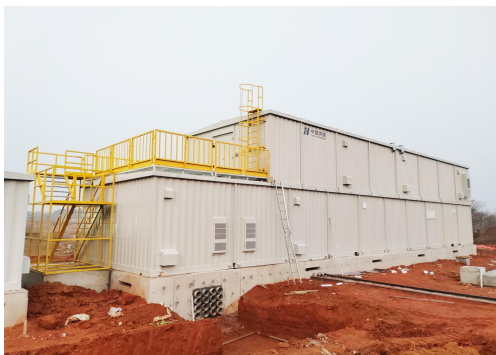
2022年12月 华能高安市蓝坊渔光互 补光伏发电项目
