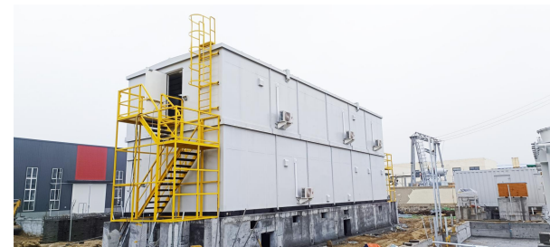
2022年9月 德州陵城区徽王庄50MW风电项目
