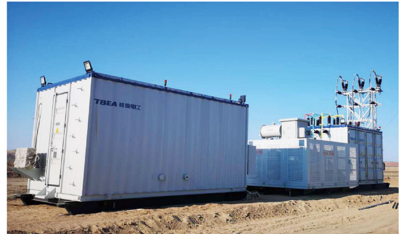
新疆天池移动变电站
