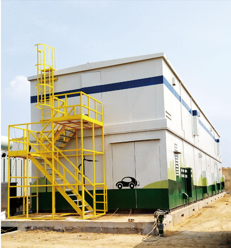
中电投乡宁风电场项目220kV升压站
