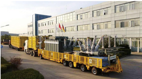
西门子-湖北车载移动变电站
