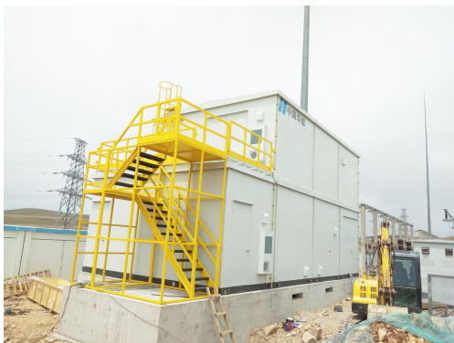
2022年6月 大山台三期风电场扩容项目
