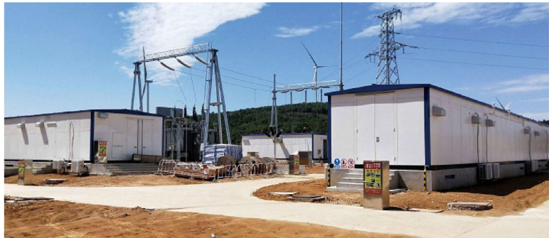
风电场35kV变电站预制舱
