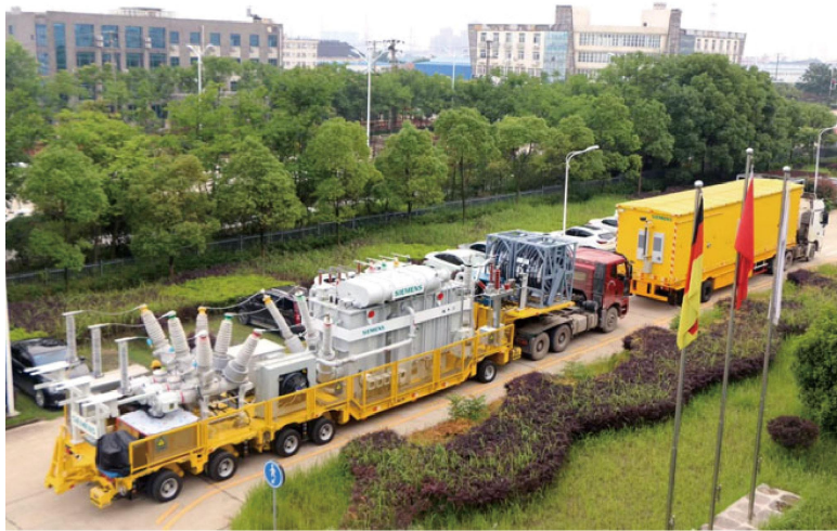
110kV车载移动变电站
