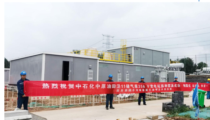
2021年7月 卫11储气库35KV预制舱式变电站
