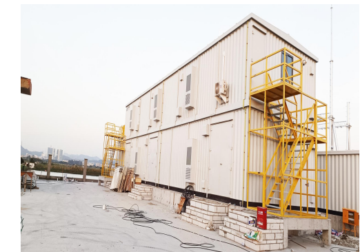
2022年12月 中成榆能源有限公司4GW光伏产业 链110kV变电站电力项目
