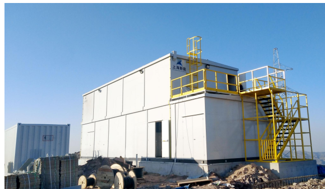
2021年12月 祁县盘陀10MW分散式风电项目
