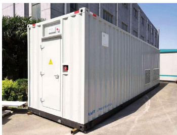
山东鲁能微网群协调控制工程集装箱
